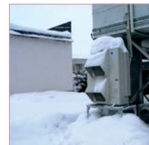
Пример эксплуатации наружного блока
